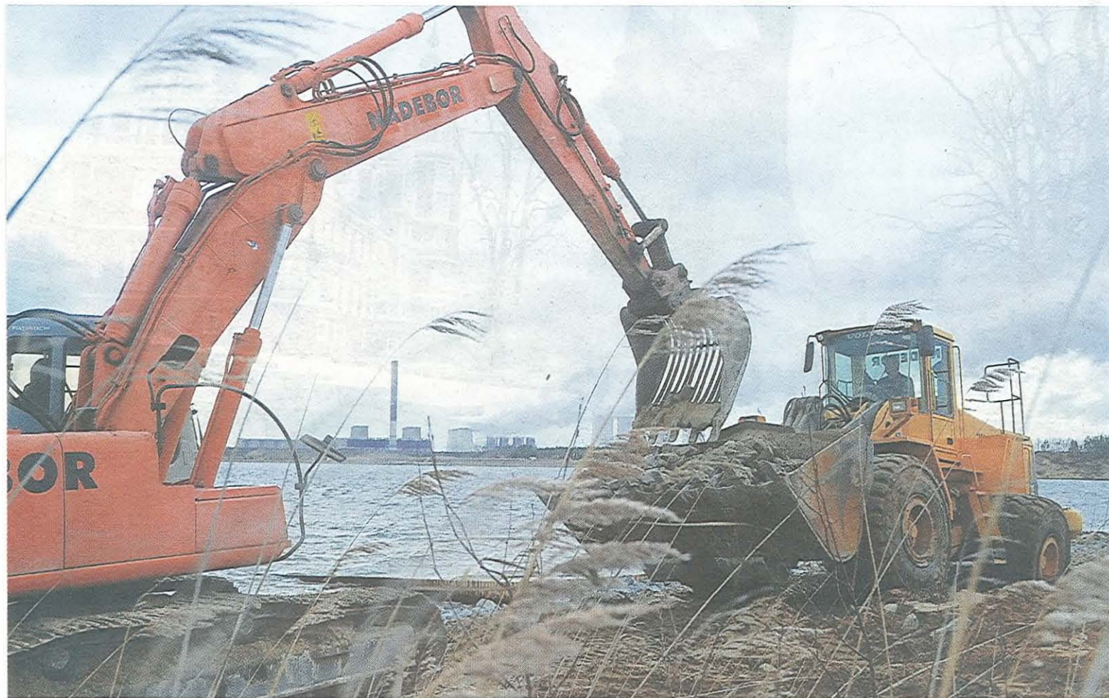
Mitarbeiter der Baufirma Nadebor schaffen vor der Kulisse des Kraftwerkes Boxberg Baufreiheit für die Mole am Boxberger Ufer.
